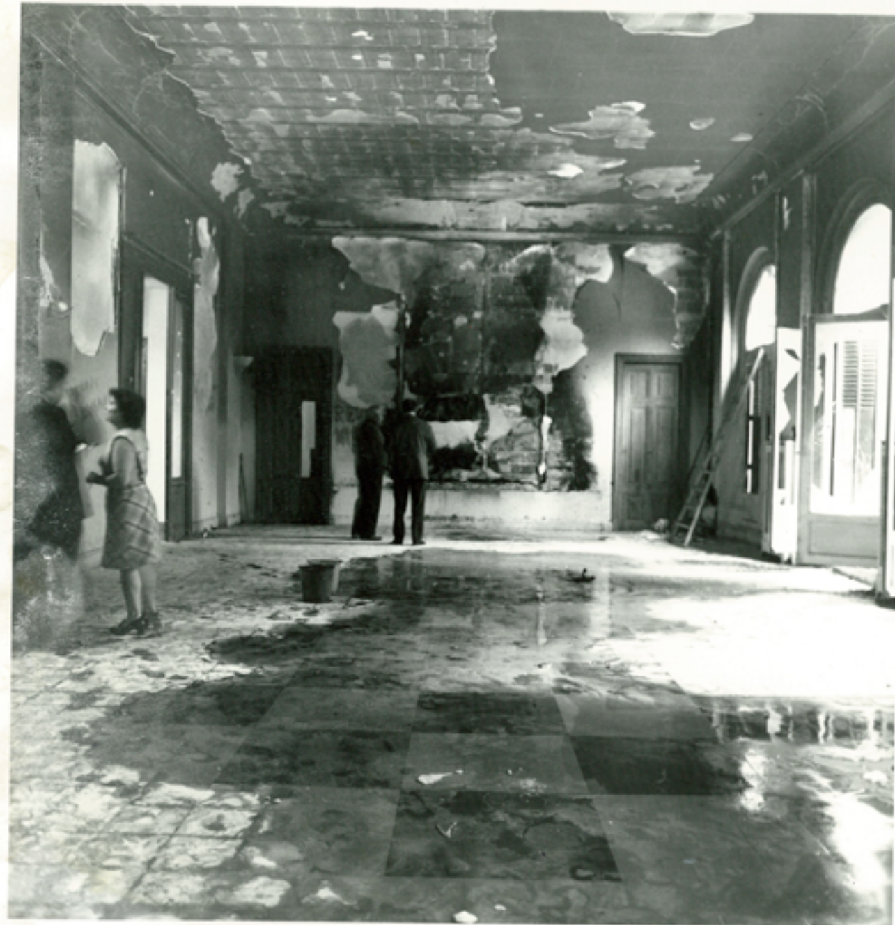
Estado en que quedó el salón de actos tras el incendio intencionado en la madrugada del 5 de mayo de 1975.
